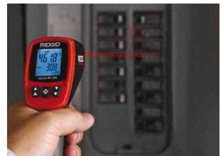
Verificar o sobreaquecimento do fusível ou do disjuntor, o que poderia ser causado por circuitos sobrecarregados.
